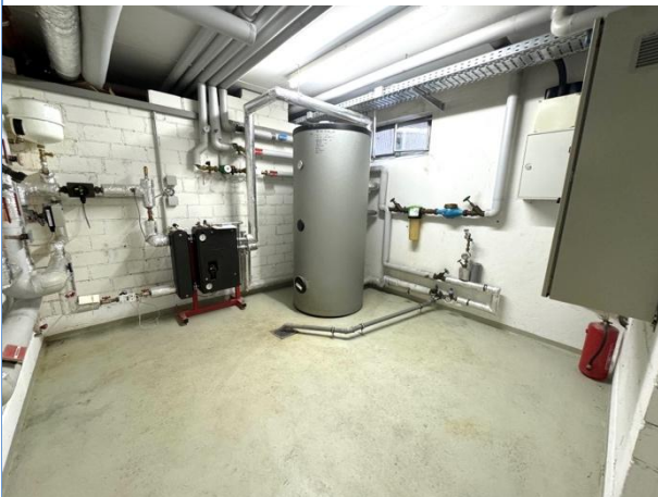
Heizungsraum des Hauseingangs (Zentrale separat)
